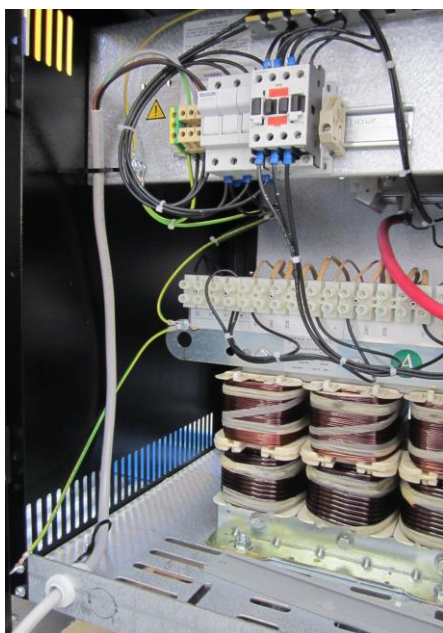
Cette image montre comment se réalise la connection du réseau dans l'armoire LP
